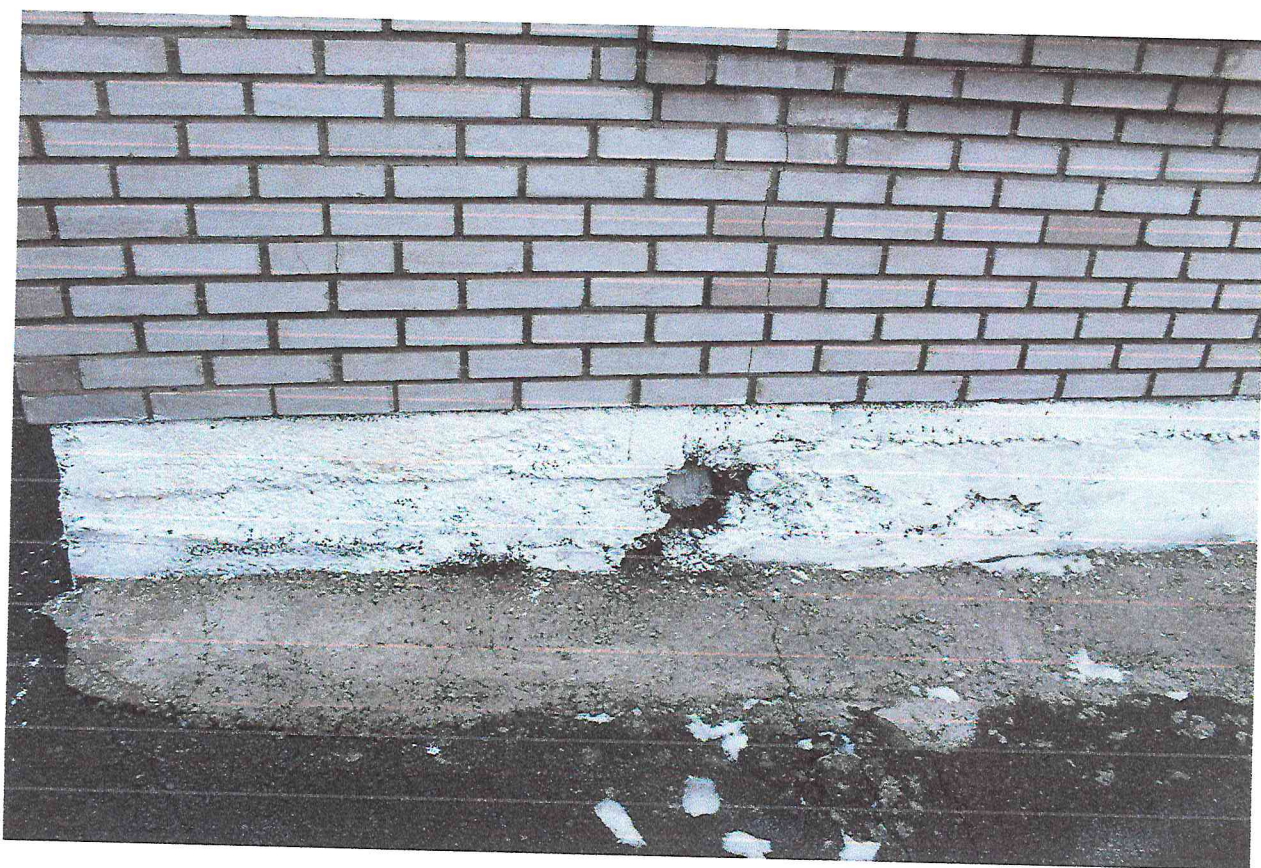
Фото 9. Западный фасад объекта культурного наследия. Трещина в кирпичной облицовке.
